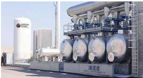
Impianto a carboni attivi (gentile concessione DEC Impianti)
